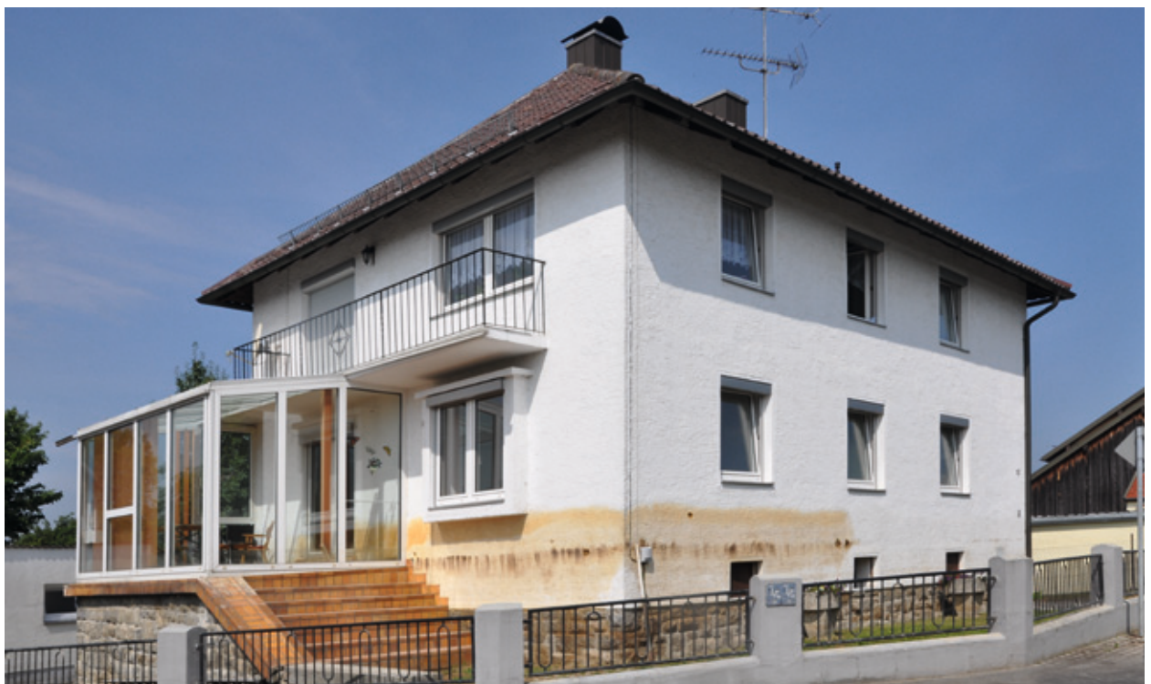
Mit Heizöl belastetes Wärmedämm-Verbundsystem eines Wohnhauses
